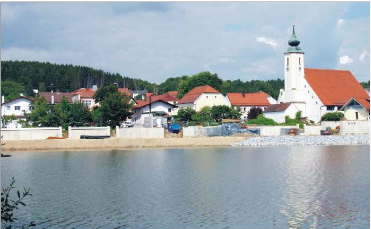
Abb. 26: Blick auf den Ortskern des Marktes Windorf von der Donauinsel. Teile der Hochwasserschutzmauer sind bereits fertiggestellt.
